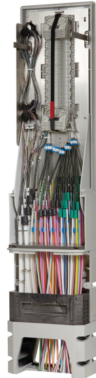
▲ Gf-NVt M 2.6 geöffnet ohne Sockelklappe
