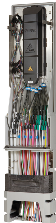
▲ Gf-NVt M 2.6 geöffnet ohne Sockelklappe
