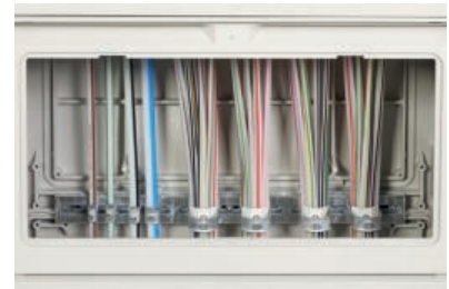
▲ Sockel mit geöffneter Klappe und montierten Mikrorohren
